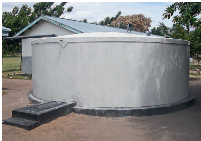
Färdig tank med manlucka och stega för rengörning, ventilation med nät och koppling till takrännor.
