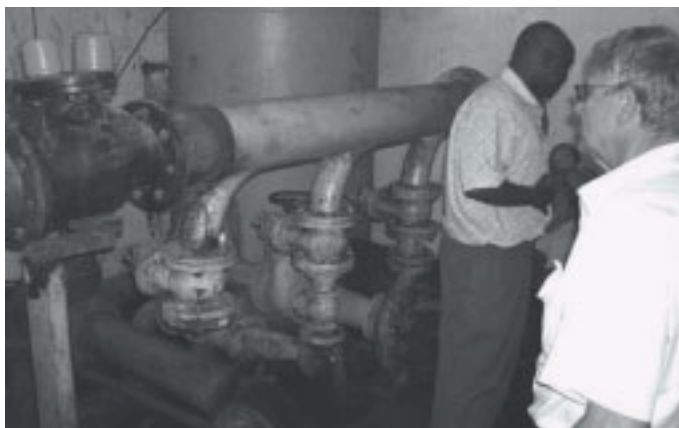
Karl Henry Olsson tittar på en pumpstation i Kibaha.
